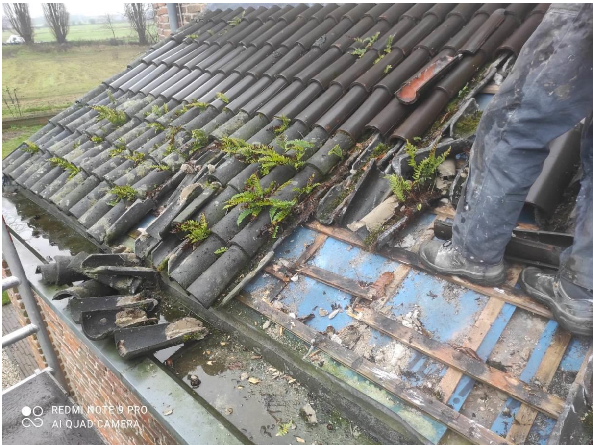
Bij het verwijderen van de varens bleken de monniken en nonnen dakbedekking los te liggen op het dakvlak van de noordelijke bedstee (foto hierboven) en de noordelijke entree.
